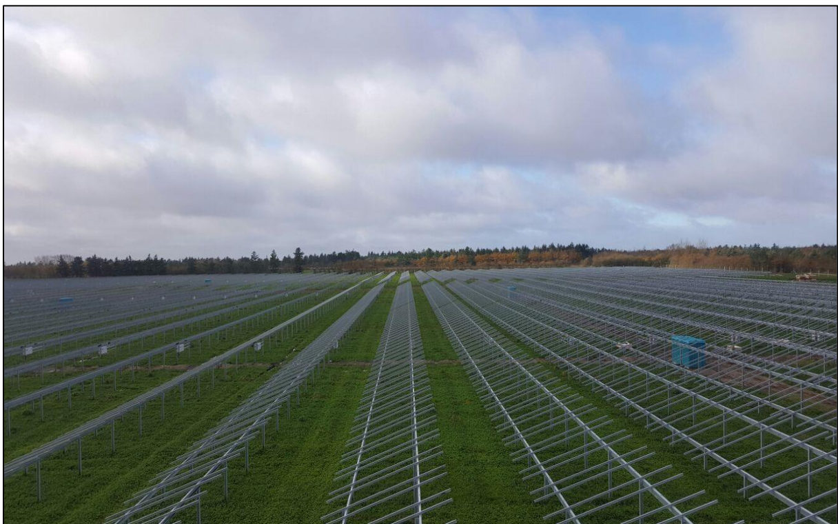
Rysunek 12. Konstrukcja wsporcza oparta na dwóch rzędach profili wbitych bezpośrednio w grunt
