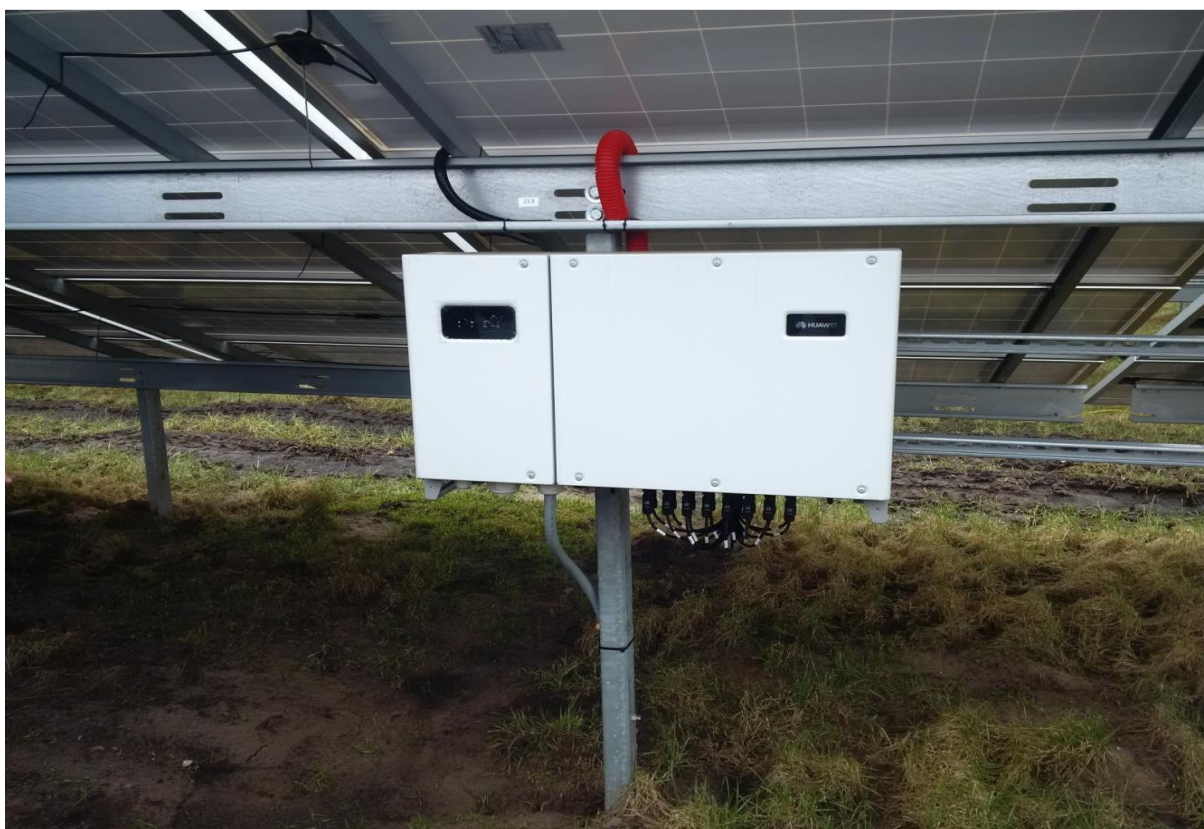
Rysunek 14. Inwerter o mocy 42 kW zamocowany na konstrukcji nośnej paneli fotowoltaicznych.
