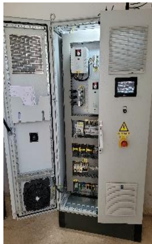
Modernizacja układu automatyki i sterowania ujęcia wody w Ludziszławicach
